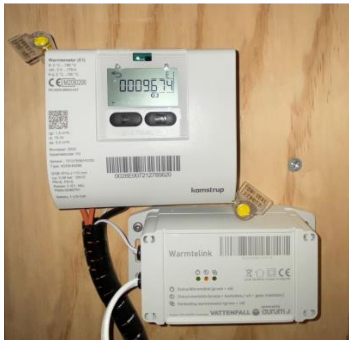
In de meterkast hangt boven de stadsverwarmings-unit de GJ-meter voor het registreren van de warmte en warmwatervraag.
