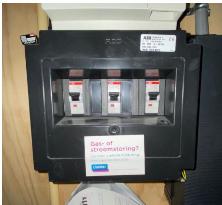
In de meterkast bevinden zich de hoofdschakelaars.
