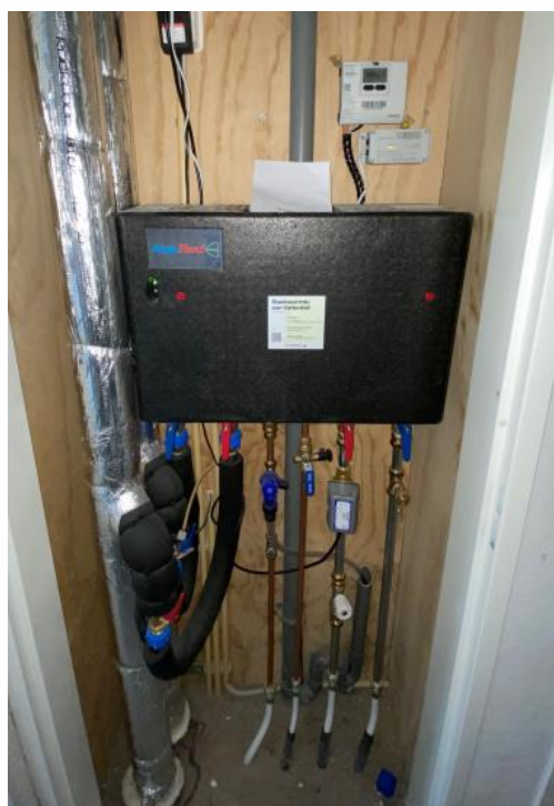
In de meterkast bevindt zich de stadsverwarmings-unit.
