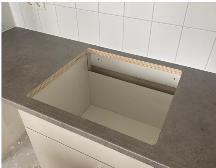
In het aanrecht is een uitsparing weggelaten voor het plaatsen van een inductiekookplaat
