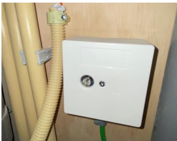
In de meterkast zit de CAI-aansluiting
